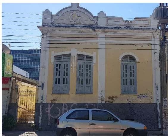
Figura 2 - Imagem frontal da edificação, com deformações.
